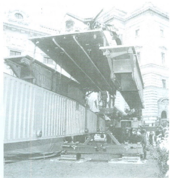
Foto 5: De wegdelen worden door het brugslagvoertuig op de centrale langsligger geplaatst en naar de overkant geschoven. De wegdelen klappen door de zwaartekracht vanzelf open.
